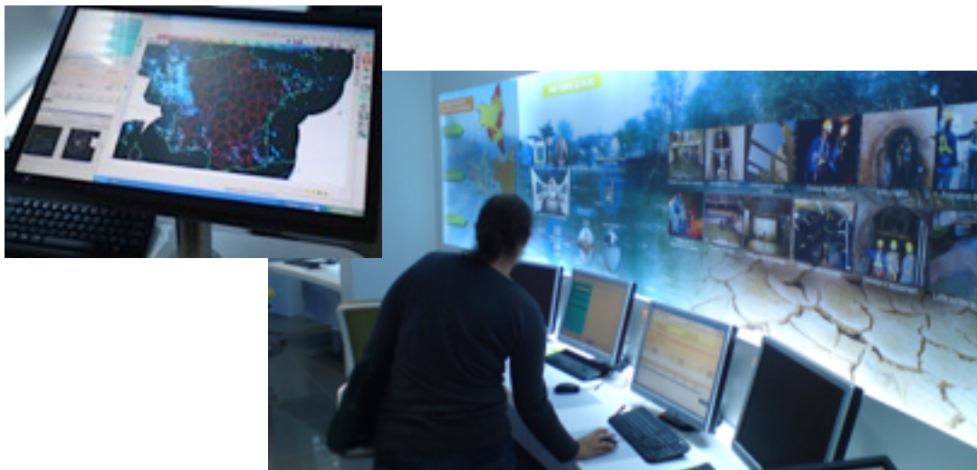
Image 7. NIAGARA : la centrale de gestion automatisée du réseau d'assainissement de la DEA (Direction de l'Eau et de l'Assainissement) du CG93. [© Auguste Gires, HM&Co - École des Ponts ParisTech]
